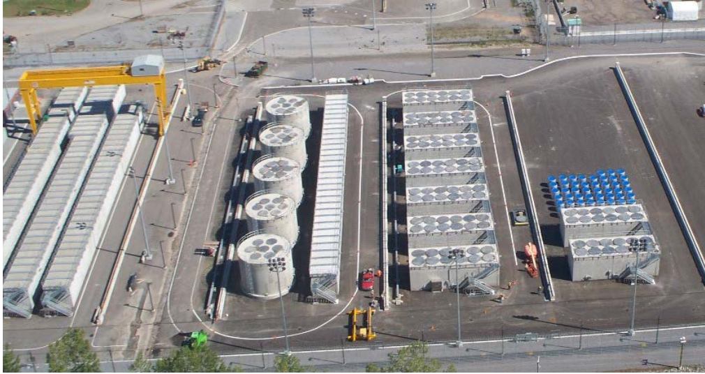
Figure 5.3 : Installation de gestion des déchets radioactifs solides de Gentilly-2
