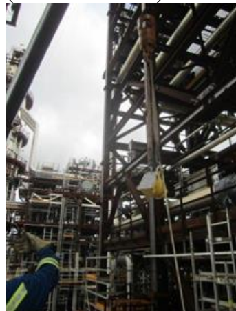
Figure 48 : Installation d'une jauge fixe par une compagnie d'entretien (Source : CCSN)
