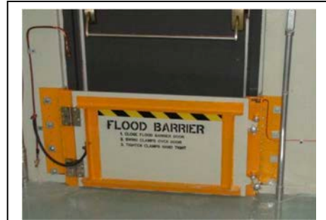
Une barrière de protection contre l'inondation récemment installée à la centrale nucléaire de Darlington
