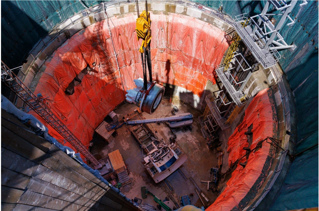
Figure 2 : Puits du circuit d'eau de refroidissement (source : OPG, août 2026)
