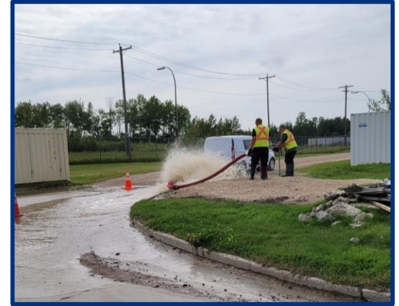
Essai de débit d'une borne d'incendie
