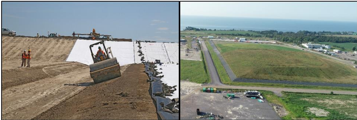
Figure 15: Installation du revêtement (à gauche) et installation recouverte et fermée (à droite) à Port Granby (Ontario)
