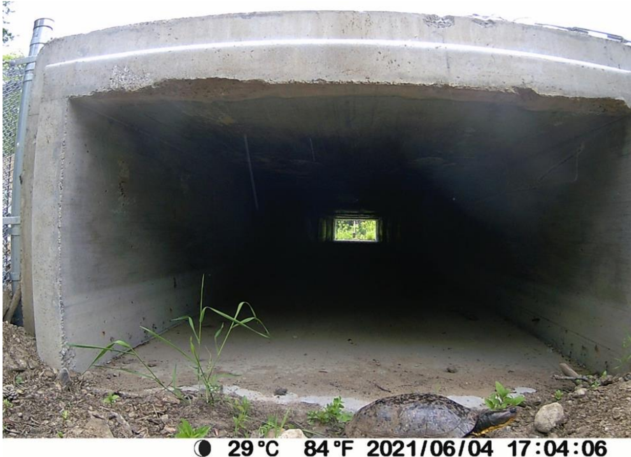
Figure 26: Tortue mouchetée à proximité d'un couloir de passage pour la faune (ponceau) nouvellement installé sur le site de Chalk River
