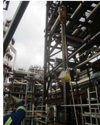
Figure 48 : Titulaire de permis d'entretien installant une jauge fixe dans une raffinerie (Source : personnel de la CCSN)
