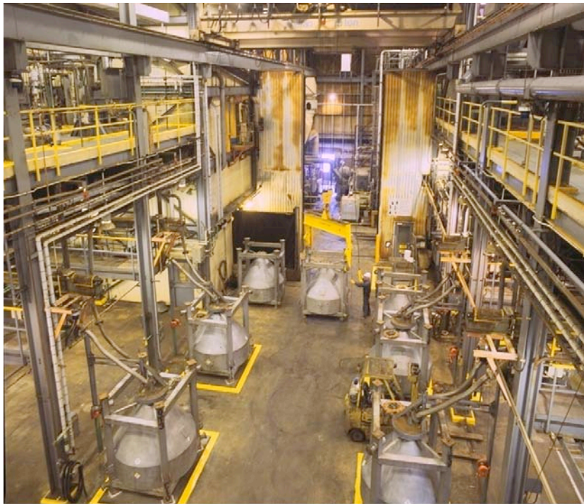
Figure 5.8 — Raffinerie de Cameco à Blind River
