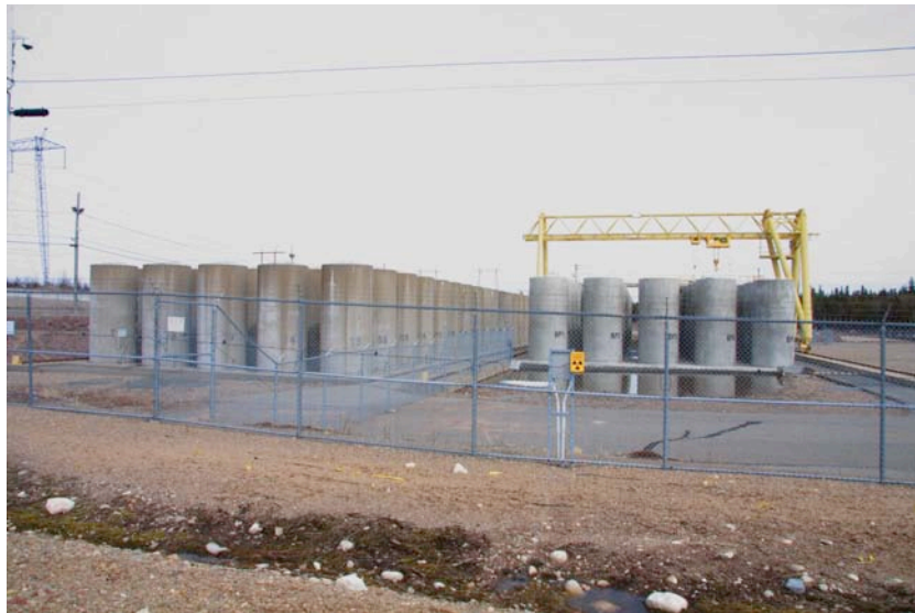
Figure 4.8 — Zone de stockage à sec du combustible usé de Point Lepreau
