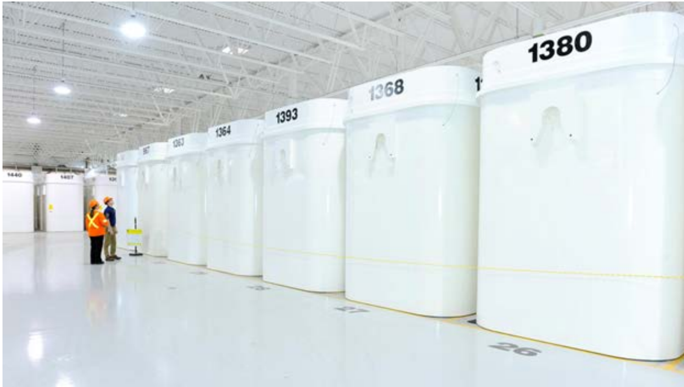
Conteneurs de stockage pour du combustible utilisé entreposé à l'installation de gestion des déchets Western d'OPG
