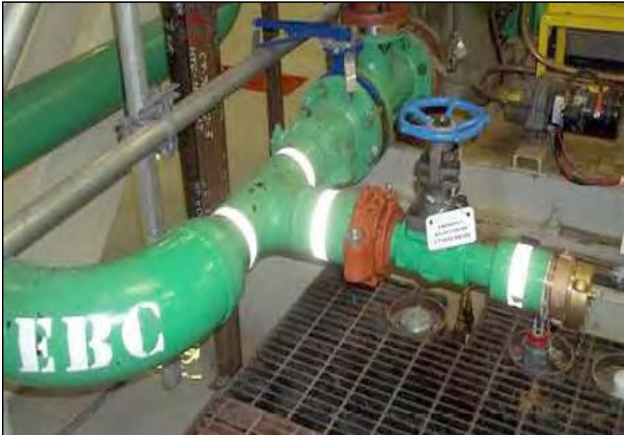
Points de raccordement à l'approvisionnement en eau
