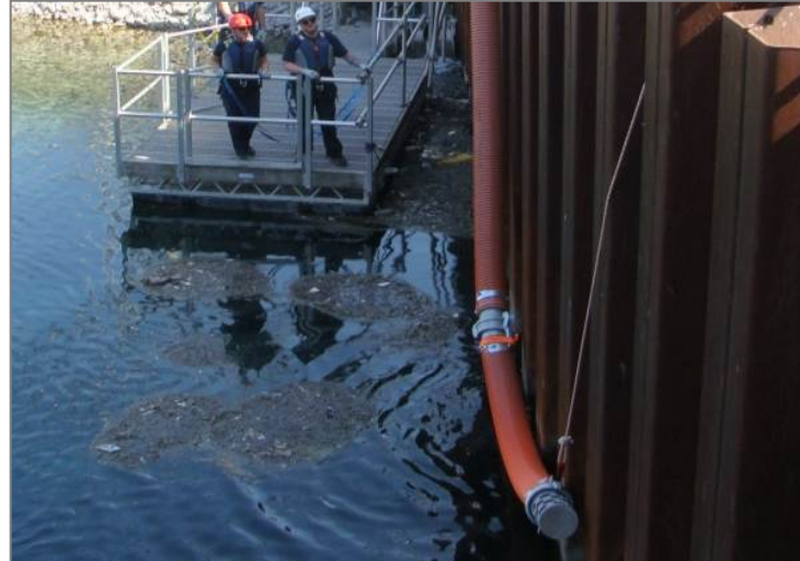
Source d'eau en cas d'urgence de la centrale de Darlington.
