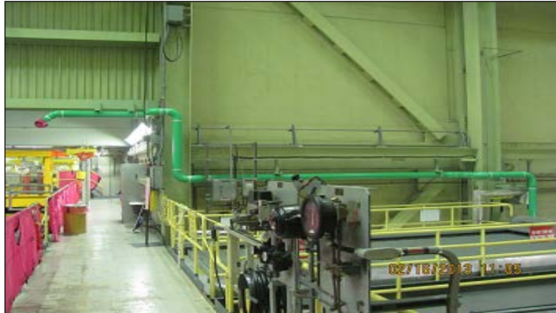
Conduits permanents menant à la piscine de stockage de combustible usé
