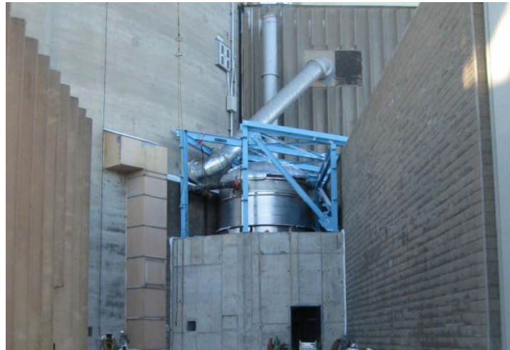
Évent avec filtre à l'intérieur du confinement de Point Lepreau
