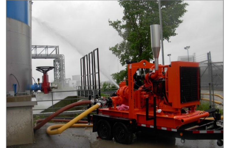
Grâce à ses pompes portatives d'urgence, la centrale de Darlington est encore mieux préparée aux situations d'urgence.
