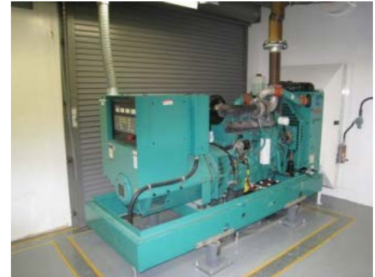
Générateur diesel de secours (juin 2008). Photo : Laboratoires de Chalk River
