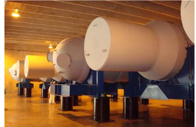
Générateurs de vapeur en état de stockage sûr
