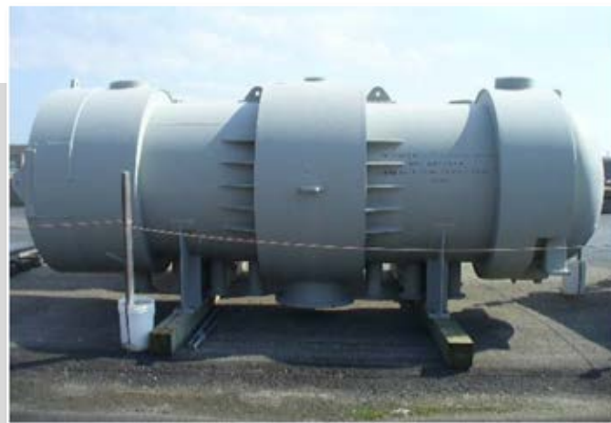
Échangeur de chaleur retiré du service
