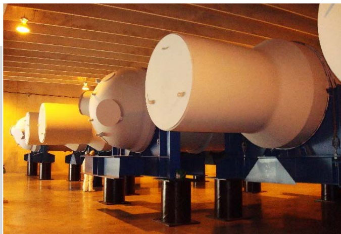
Générateurs de vapeur retirés du service des tranches 1 et 2 de Bruce Power
