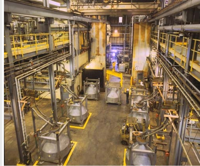
Conteneur d' \text{UO}_3 et poste de manutention à la raffinerie de Blind River.
