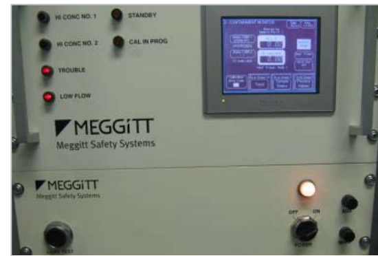
Système d'échantillonnage et de surveillance en cas d'accident grave
