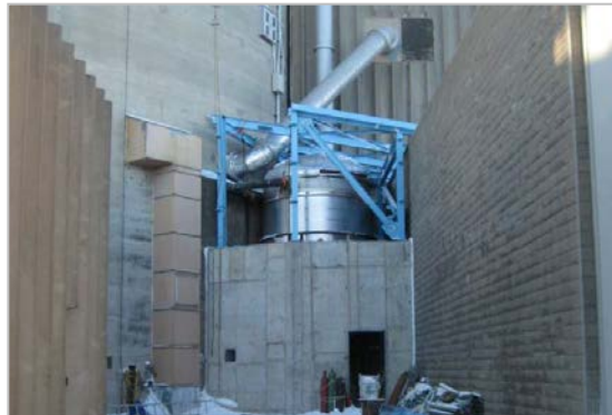
Système de ventilation d'urgence du confinement avec filtrage
