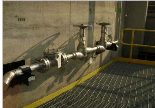
Système d'appoint de l'enceinte de la calandre à Point Lepreau
