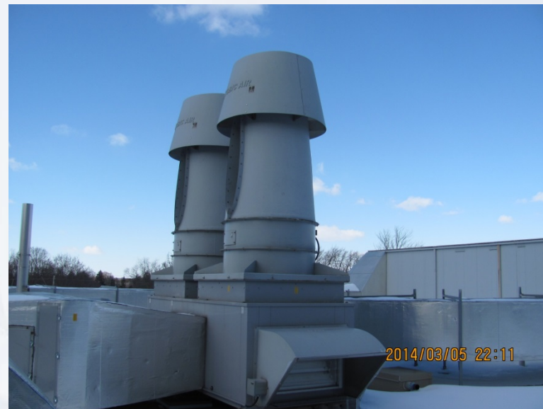
Cheminée d'échappement d'un cyclotron (source : CCSN)
