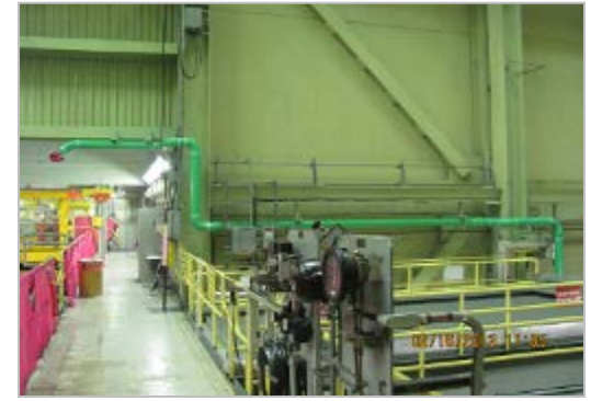
Branchement permanent à la piscine de stockage de combustibles
