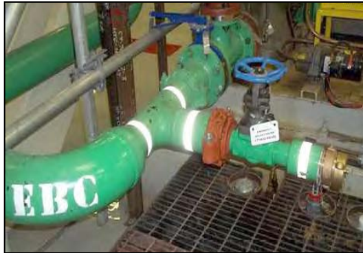
Points de connexion à l'approvisionnement en eau
