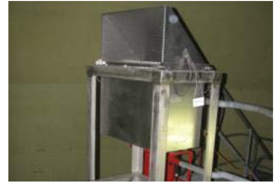
Le contrôle et l'atténuation de l'hydrogène avec les titulaires de permis ont amélioré le contrôle de l'hydrogène par l'installation de recombineurs autocatalytiques passifs
