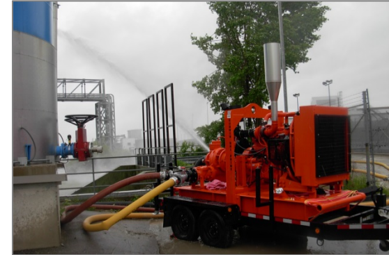
Les pompes portables d'urgence de Darlington renforcent davantage la préparation d'urgence.
