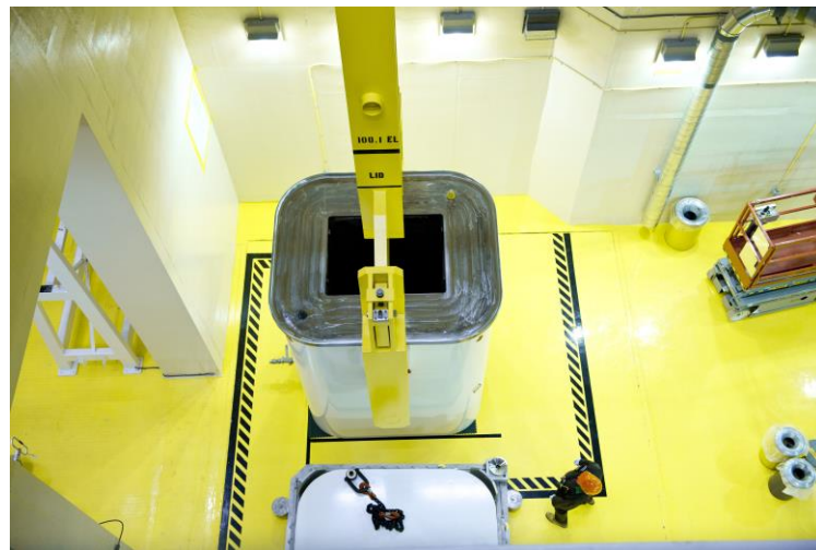
Le combustible utilisé est stocké dans de grands conteneurs de béton armé connus sous le nom de silos de stockage à sec. Chaque tonneau contient environ 400 grappes de combustible.
