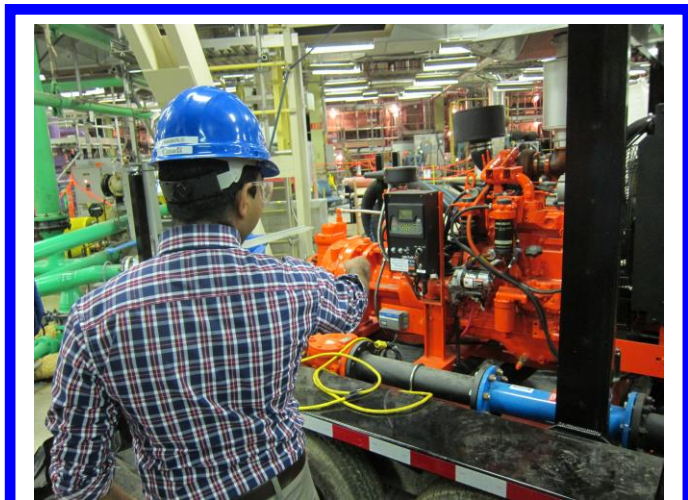
Un membre du personnel de la CCSN inspecte des pompes à eau d'urgence portables à moteur diesel. Celles-ci peuvent être utilisées en cas d'urgence afin de maintenir la circulation d'eau dans le réacteur.
