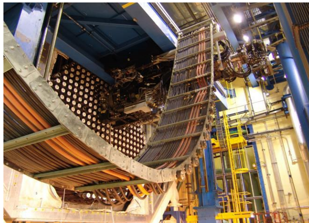
À Gentilly-2, une machine à chargement de combustible est utilisée pour retirer le combustible du cœur et vidanger l'eau lourde des tubes de force (Photo gracieuseté d'Hydro-Québec).
